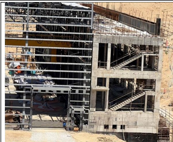
1. Строительство насосной станции. Работа на высоте без знаков и инструкций/досок безопасности.
