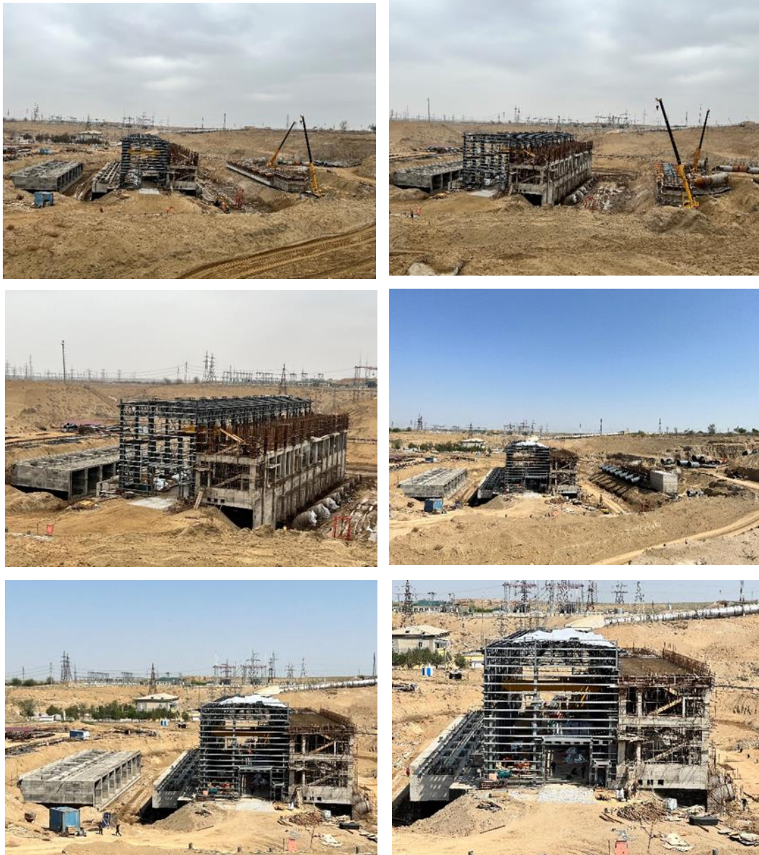
Общий вид здания насосной станции и строительство вспомогательного здания за насосной станцией (АБИСРП 01)
