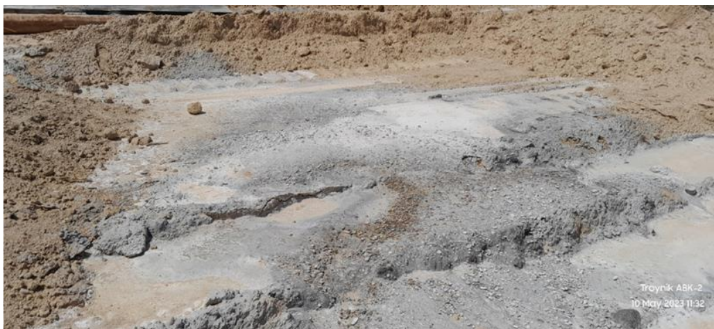
Фото 3: Бетонные отходы на земле
