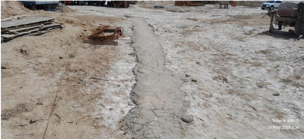
Фото 4: Отходы бетона на земле
