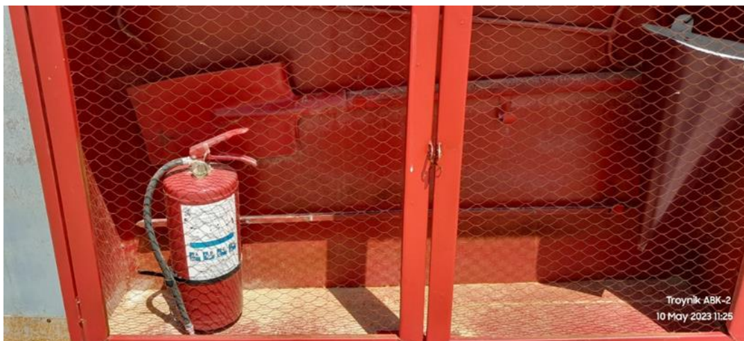
Фото 2: Запертый пожарный шкаф
